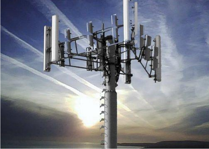
Una tipica torre di una stazione radio base della telefonia mobile.
